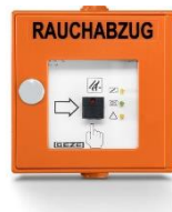
Bedienstelle Rauch- und Wärmeabzugsanlage
